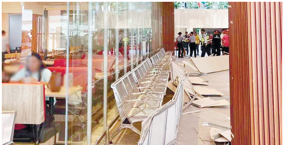
4月3日，尼茲·亞謹諾國際機場1號航站樓到達區附近的部份天花板發生坍塌。
