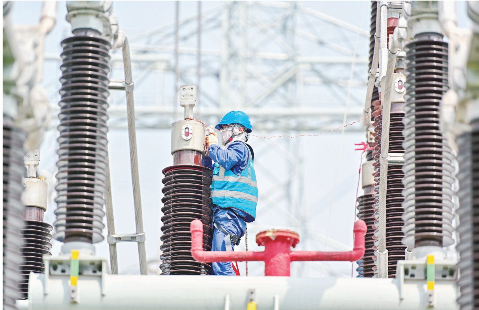
重慶1000千伏特高壓巴岳變電站首次年度檢修進入關鍵作業階段 5月11日，在重慶市銅梁區1000千伏特高壓巴岳變電站，檢修人員對3號主變開展電氣試驗工作。
