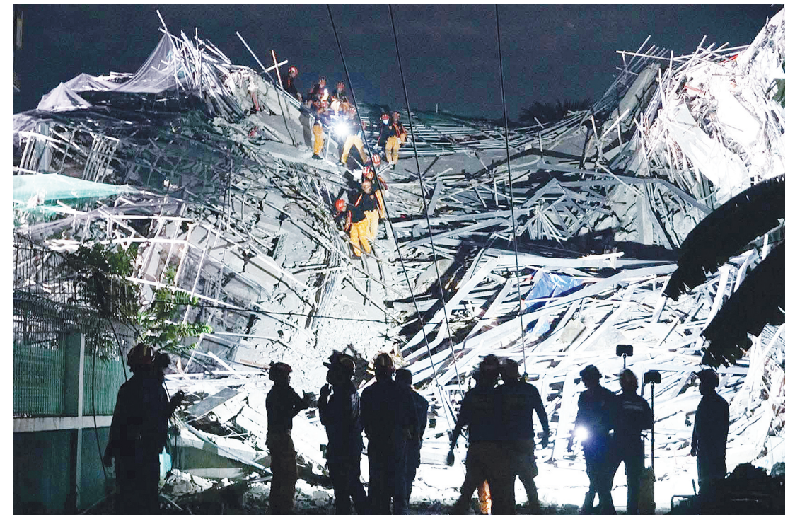
5月24日，救援人員在邦邦省紅溪禮示市的樓房坍塌現場工作。該市一棟在建樓房24日凌晨發生坍塌，已造成3人死亡，另有18人失蹤。 <新華社>
