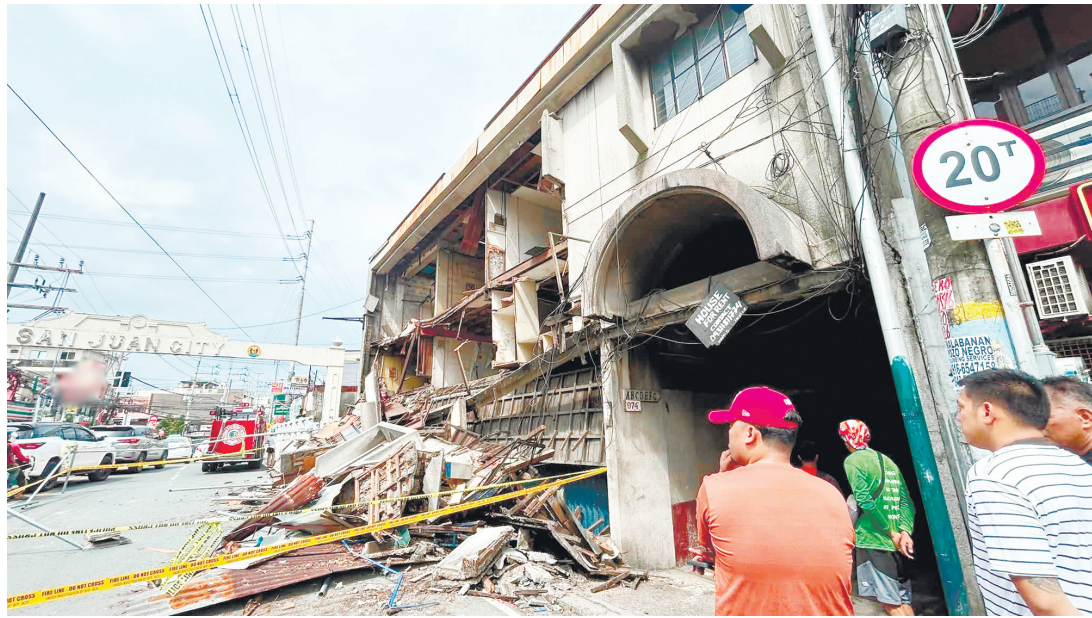
8月16日，萬達俞央市卡倫通街一棟建築物的正面部份倒塌。
